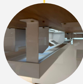
Amplia bandeja pasacables metálica debajo del tablero principal
