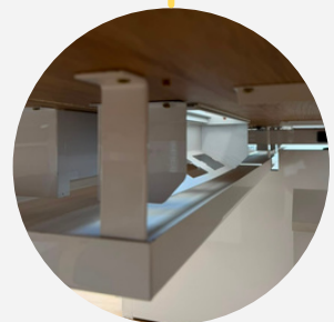
Amplia bandeja pasacables metálica debajo del tablero principal
